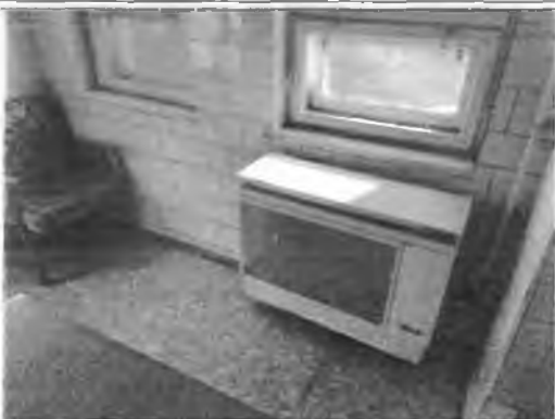
gázkonvektor a váróban
